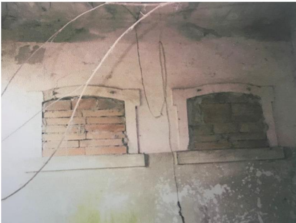
Foto n° 18 interna con fori occlusi su corpo di fabbrica principale
