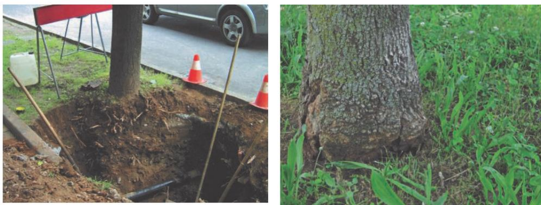
Figura 4-1: Scavi e danni da decespugliatore sono alcune delle cause più diffuse di deperimento del patrimonio arboreo, anche con innesco di gravi patologie e situazioni di instabilità
